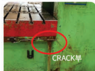
전체 Crack부 확인
